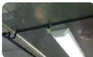
剥き出し配管例
