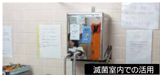
滅菌室での配管使用例(配管4ヶ所)
